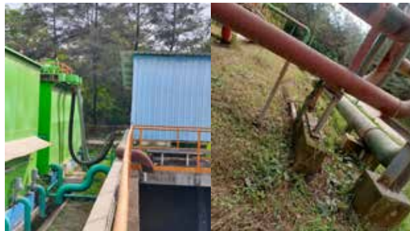
Jalur backwash untuk penyediaan air bersih asrama karyawan
